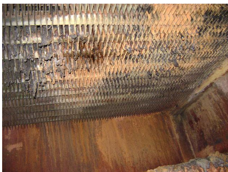
圖：中間蒸發器管道的下部，有熔化的金屬
